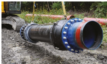
Raccord Géoflex en cours d'installation sur la conduite forcée de la centrale hydro électrique des Encombres, en Savoie
